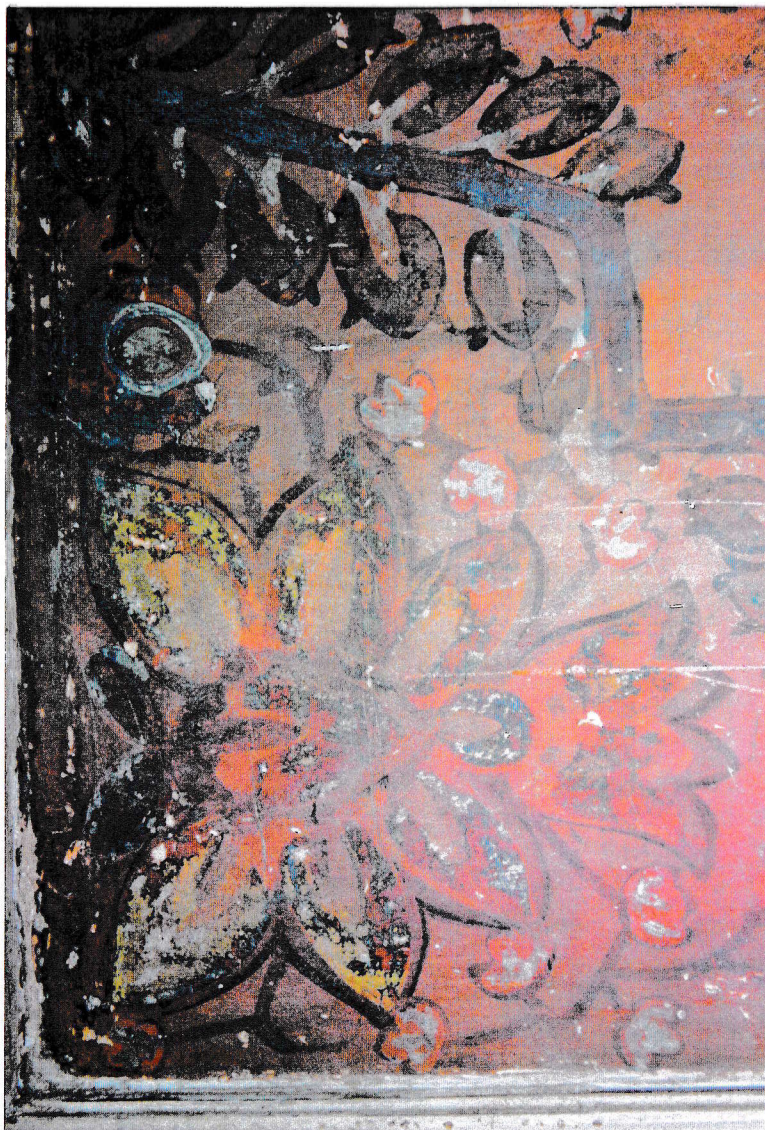
Befund, Schaden durch Ablaugen der Malschicht
